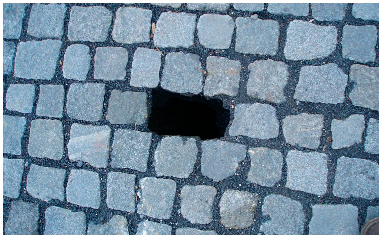
Poškození a oprava komunikací nad bývalým pivovarským sklepem - Takhle to začalo
