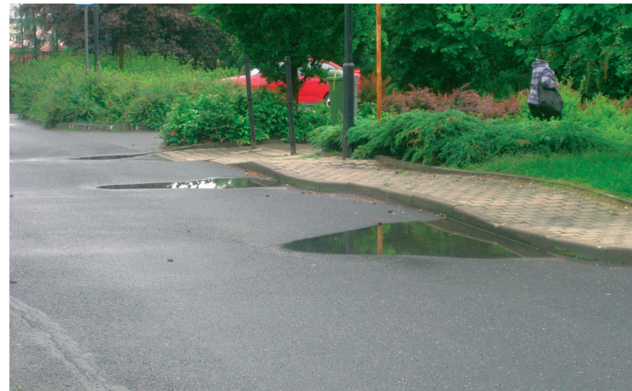
Na povrchu ulice a chodníků byla vidět zvlnění
